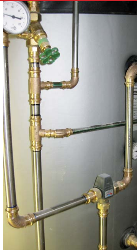
Verrohrung Trink- wasserseite
