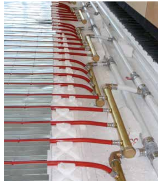
Die Anbindung der Heizkreise der Roth ClimaComfort® TBS Flächenheizung in der Hinterlandhalle Dautphetal erfolgt über ein Tichelmann-Verteilungsnetz
