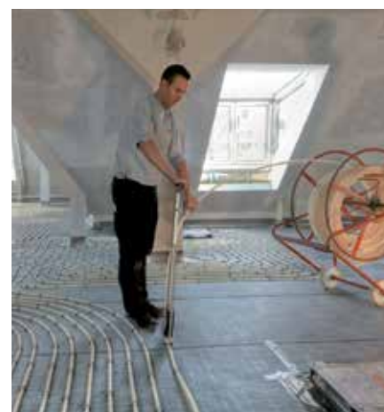
Auch im rauen Baustellenbetrieb muss das seit Jahrzehnten bewährte System nicht mit Samthandschuhen angefasst werden.
