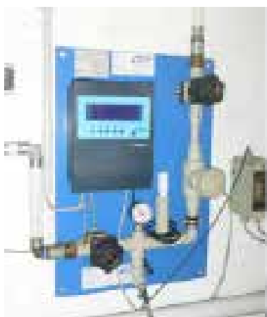
Abbildung 27: Steuereinheit Abwasser, Teilstrom 3, Kühlwasser Halle 1
