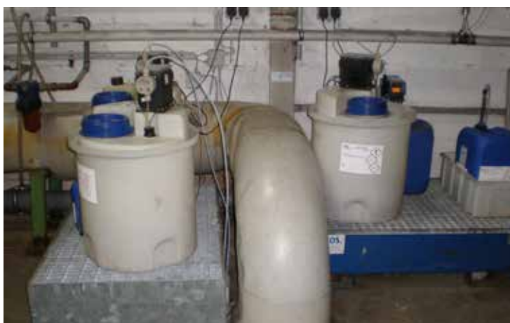
Abbildung 28: Dosiermittel mit Dosiermittelpumpen und VAWS Auffangwannen
